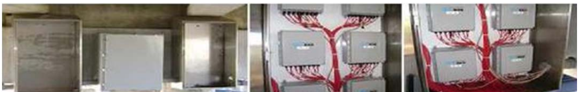
(d) Cabinets and data logging equipment.
